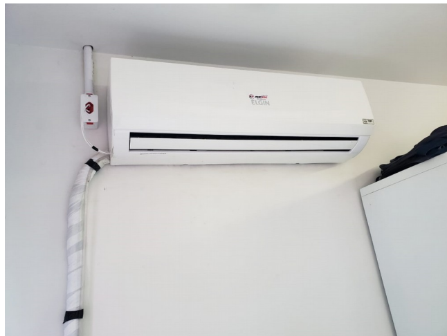
Ar condicionado – Sala dos Agentes de Saúde
