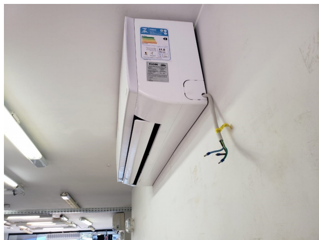
Ar condicionado – Sala de atendimento ao público
